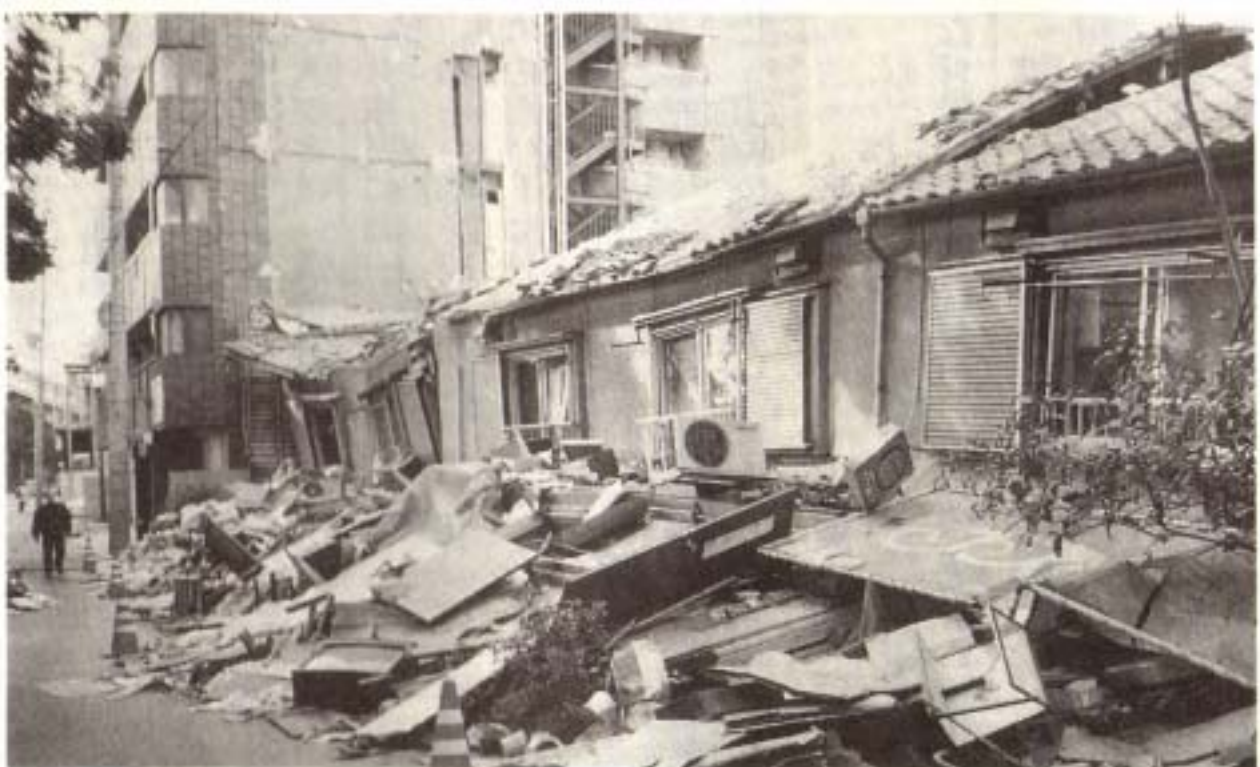
一階が壊れた神戸市内の民家
