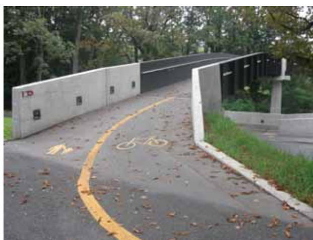
写真 17 スイス ベルンにて 自転車利用者に配慮した歩道橋（2011年9月4日 筆者撮影）
