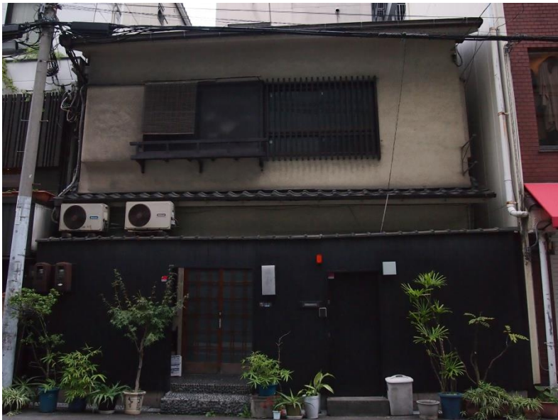
図 3-6 北堀江一丁目（北堀江御池通二丁目）に唯一現存する料亭の旧店舗、但し既に廃業
